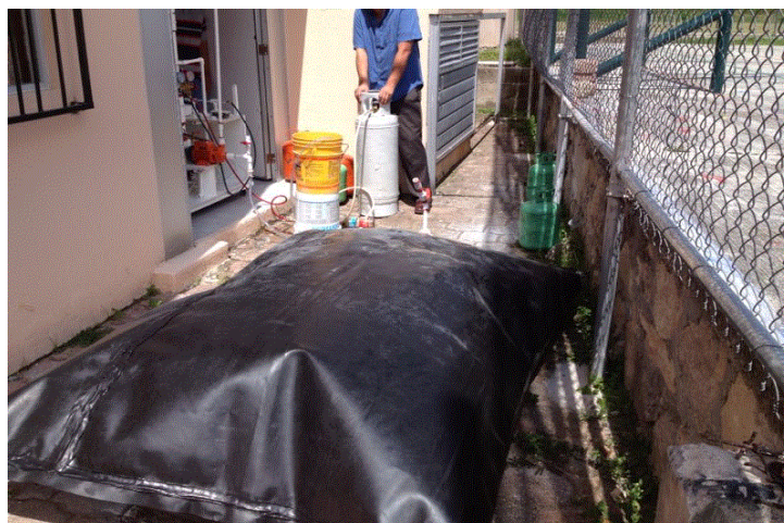
Figura 2. Equipo de Purificación y Presurizado
