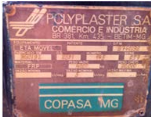
(a) Placa com informações da ETA
