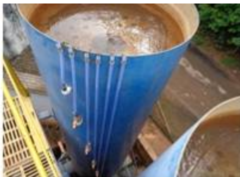
(a) Piezômetros instalados
