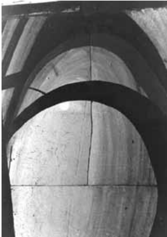
Grietas sobre lámina de asbesto-cemento causada por tensiones diferenciales.
