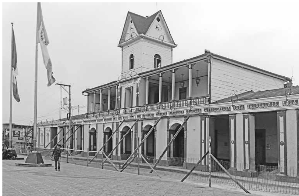
Edificio histórico dañado por el sismo del 2012 en la ciudad de San Marcos. Fotografía: Gilda Rivera (GR), abril de 2015
