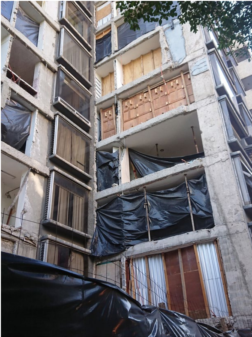
Edificio de vivienda en la colonia Juárez, el cual tenía aproximadamente 38 años de construido, es decir, había soportado el sismo de 1985 y solo presentó un daño menor. Actualmente se encuentra en proceso de rehabilitación. Fotografía de la autora.
