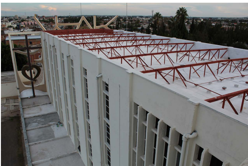
Imagen 2. Vista desde el campanario de las naves lateral, central y estructura de la losa. Fotografía: NGGE.
