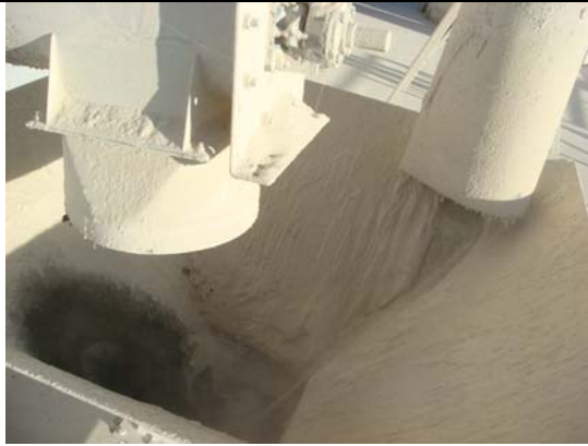
Descarga do lodo desidratado e descarga de cal no misturador.
