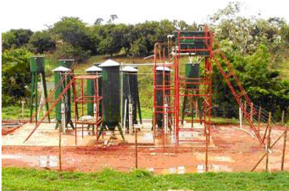
FIGURA 1: Vista geral da instalação piloto da FiME
