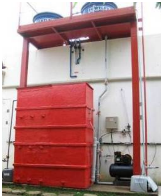
Figura 2: Vista geral do sistema de tratamento
