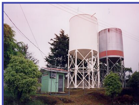
Tanques de almacenamiento. Cartago
