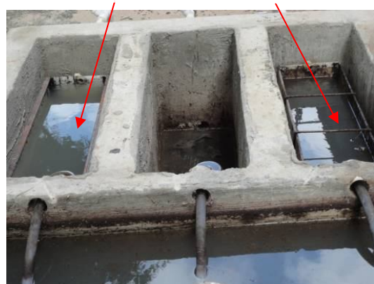
Figura 4. Caixas limitadoras de vazão
