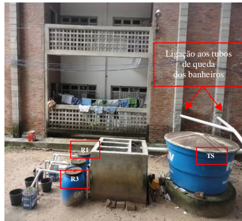
Figura 2. Foto geral do sistema de tanque séptico e demais reatores anaeróbios
