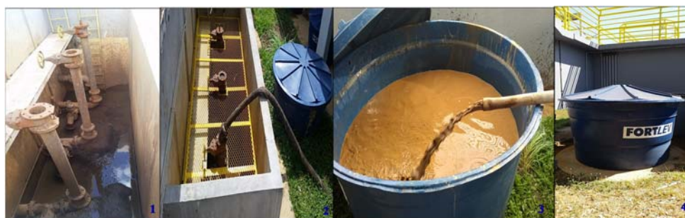
Figura 2. Coleta do “Resíduo Mãe”: tubulação de descarga de resíduo do Decantador I (1), detalhe do mangote na tubulação de descarga do decantador (2), enchimento do resíduo no reservatório de 2000 L (3), resíduo mãe armazenado no reservatório (4).
