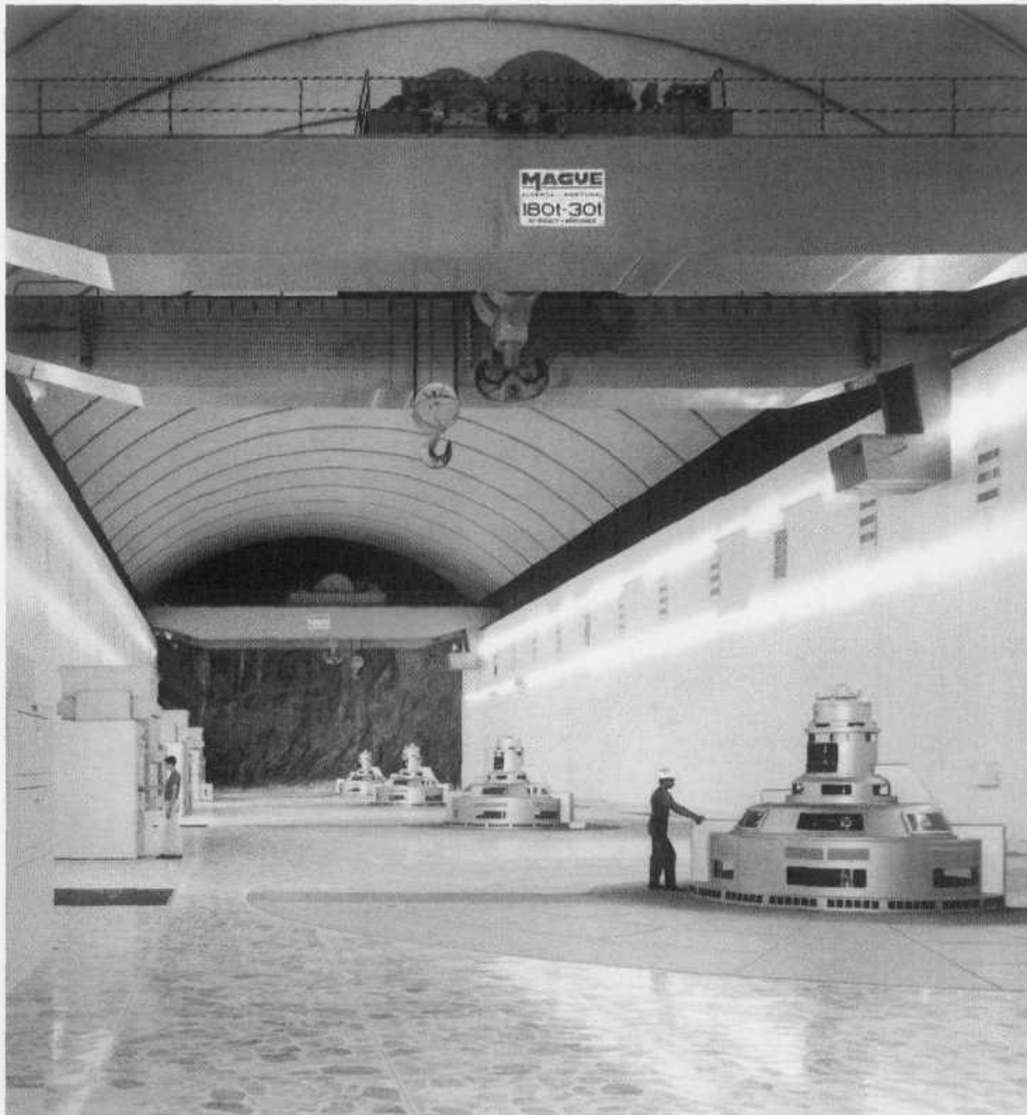
Casa de máquinas de la Presa Infiernillo
