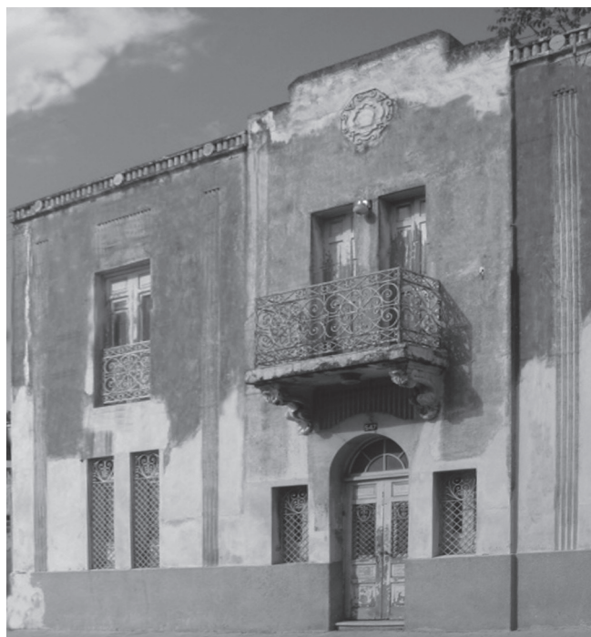
Ejemplo de vivienda art decó en estado de deterioro propiciado por el abandono habitacional fomentado durante el último tercio del siglo XX. El más destructivo que ha sufrido el patrimonio de la ciudad
