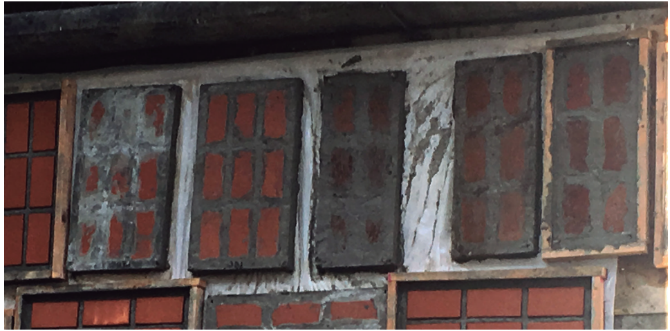
Pruebas de fachada para la casa Domínguez. Placas de cerámica armada prefabricada. Imagen de los autores
