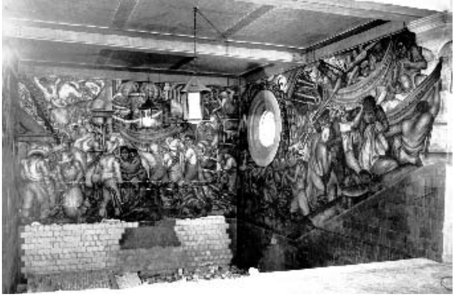
Marion Greenwood. Muros sur y poniente. Durante los trabajos de demolición del entarimado y muretes de ladrillo. El muro frontal presenta fracturas y filtraciones de agua de lluvia desde el plafond hasta la parte inferior por escurrimientos que han erosionado la película de pintura.
