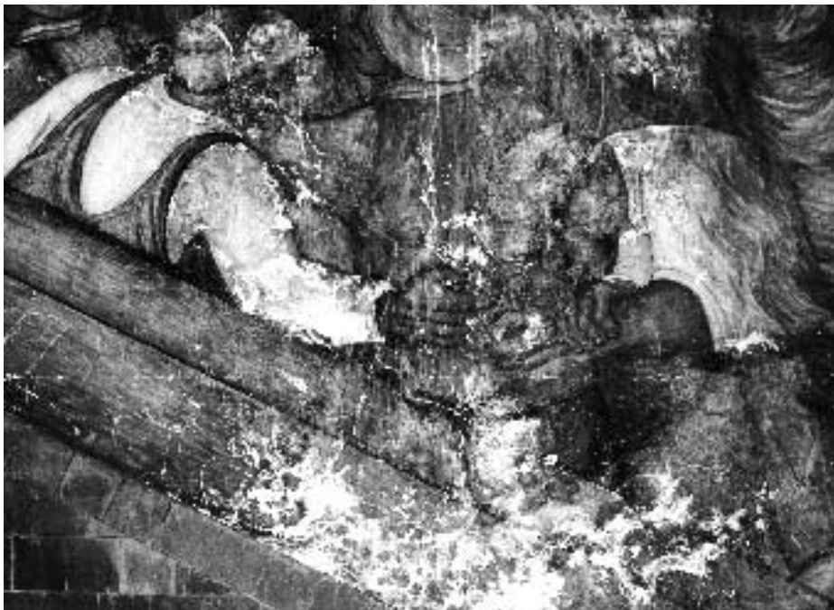
Grace Greenwood. Daños producidos por la filtración de humedad y fracturas por movimientos de la estructura, 9 de diciembre de 1976.
