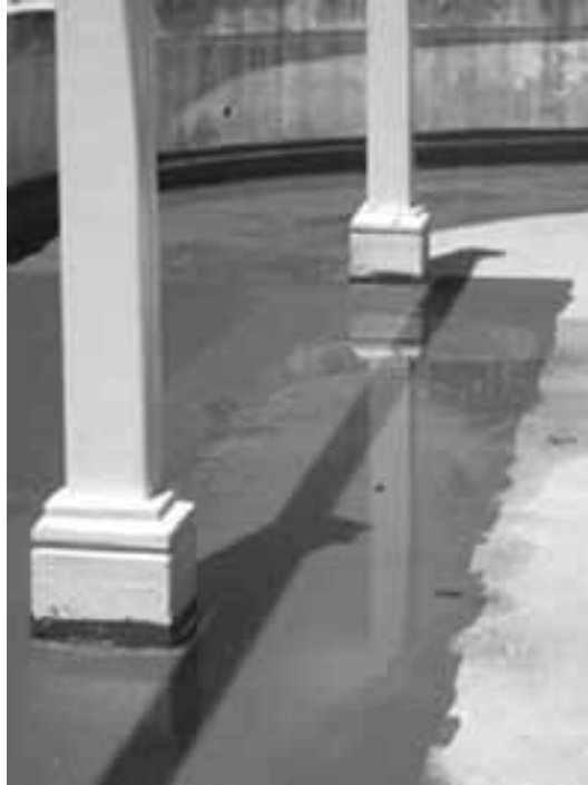
Humedad: agua acumulada en la azotea.
